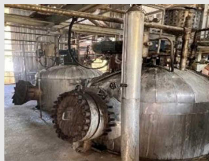
RHD03/RHD04/RHD05 - REATORES DE HIDROGENAÇÃO MATERIAL - AÇO INOX CAPACIDADE DE 04 TONELADAS | Item: 103 |
