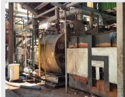
CAD01 - CALDEIRA DE GERAÇÃO DE VAPOR TIPO - FLAMOTUBULAR CAPACIDADE 02 TONS/H | Item: 98 |
