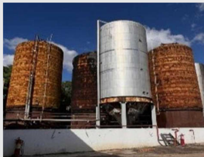
TQMP01 /TQMP02/TQMP03/TQMP04 - TANQUES ARMAZENAMENTO MATERIA PRIMA MATERIAL - AÇO INOX CAPACIDADE - 140 TONELADAS | Item: 99 |
