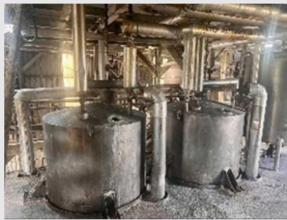
TQM01/TQM02 - TANQUES DE MEDIDA CAPACIDADE - 4 M³ | Item: 37 |
