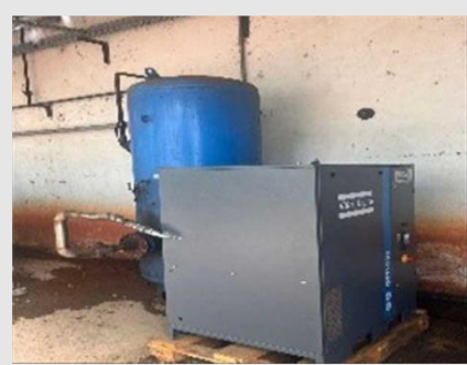
CA01- COMPRESSOR DE AR MODELO - G22VSD POTENCIA - 192,24 M³/H | Item: 49 |
