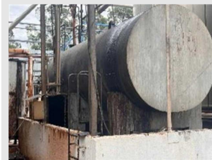
TQER03 - TANQUE ESTOCAGEM DE RESIDUO MATERIAL - AÇO CARBONO CAPACIDADE - 12 M³ | Item: 76 |
