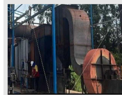
CAL04 - CONJUNTO CALDEIRA/QUEIMADOR COMPLETO TIPO - AQUATUBULAR MODELO - IFS-50 POTENCIA - 5,0 GCAL/H | Item: 57 |
