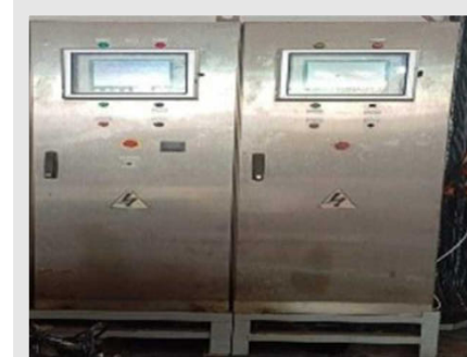
PSA01 - PAINEL COM SISTEMA DE AUTOMAÇÃO COMPLETO | Item: 45 |
