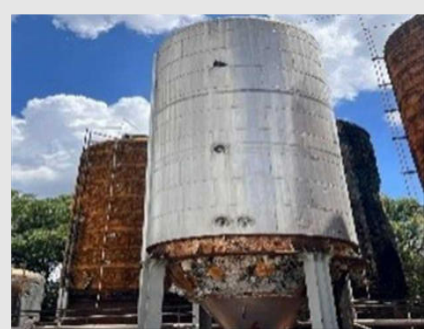
TQMP06 - TANQUE TANQUES ESTOCAGEM MP MATERIAL - AÇO INOX INOX CAP. 150 M³ | Item: 1 |
