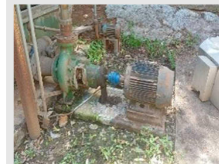
MBTR01 - BOMBA ÁGUA TORRE RESFRIAMENTO - POTENCIA - 10VC | Item: 48 |
