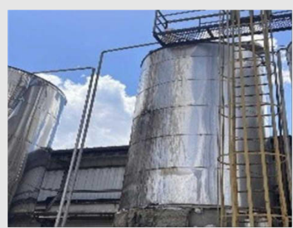
TQM01 - TANQUES DE MISTURA MATERIAL - AÇO INOX CAPACIDADE - 25M³ | Item: 55 |
