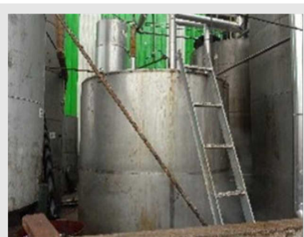
TIAGD01 ? TANQUE INTERMEDIARIO DE ÁCIDO GRAXO DESTILADO MATERIAL INOX CAPACIDADE: 10,39 M³ MARCA USDA | Item: 19 |
