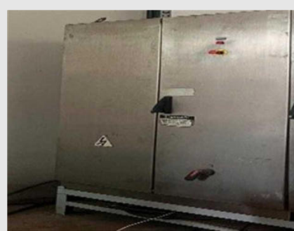
PE01 - PAINEL ELETRICO | Item: 44 |
