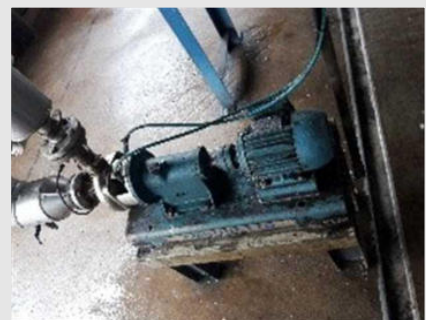
BTPAGD01 ? BOMBA TANQUE PULMÃO ÁCIDO GRAXO DESTILADO MARCA WEG CAPACIDADE: RPM 3120 / CV 1,0 | Item: 22 |
