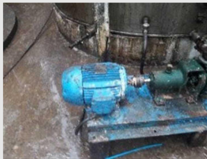
BTQAG01 ? BOMBA TANQUE AG (ALIMENTAÇÃO DO DESTILADOR) MARCA CAPACIDADE: RPM1740 / CV 7,5 | Item: 25 |
