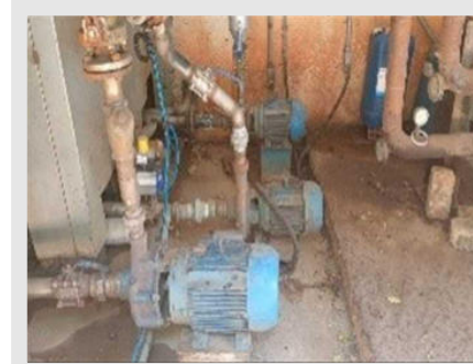
MBAG01/MBAG02/MBAG03 - BOMBAS SISTEMA AGUA GELADA | Item: 51 |
