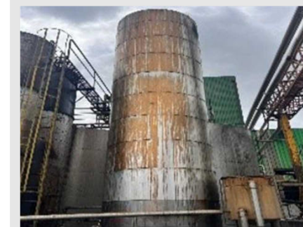
TQEEL01 - TANQUE ESTOCAGEM ESTEARICO LIQUIDO (CHEMSON) MATERIAL - AÇO INOX CAPACIDADE - 28 M³ | Item: 77 |
