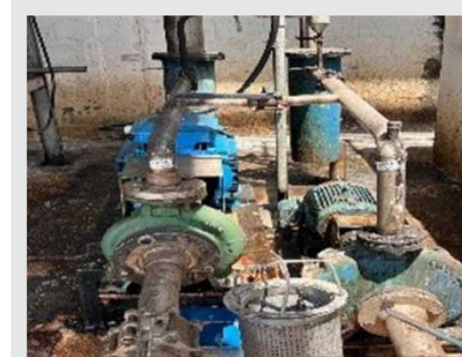
MBRMP01/MBRMP02 - BOMBAS RECEBIMENTO DE MATERIA PRIMA POTENCIA - 15 CV / 60CV | Item: 3 |
