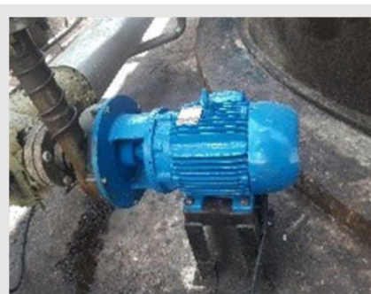
BTEAGD01 ? BOMBA TANQUE DE ESTOCAGEM DE ÁCIDO GRAXO DESTILADO MARCA WEG CAPACIDADE: RPM 3500 / CV 7,5 | Item: 20 |
