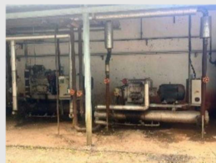
CSR01/CSR02 - COMPRESSORES SISTEMA DE RESFRIAMENTO (CHILLER SABROE) | Item: 46 |
