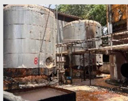
TQMP01 E TQMP08 - TANQUES ESTOCAGEM MP MATERIAL - AÇO INOX INOX CAP. 60 M³ | Item: 2 |
