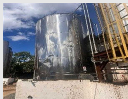
TQINS01 - TANQUES DE INSATURADO MATERIAL - AÇO INOX CAPACIDADE - 60M³ | Item: 53 |
