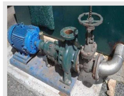
BPQ01 ? BOMBA DO POÇO QUENTE MARCA KSB CAPACIDADE: RPM 3150 / CV 1,0 | Item: 21 |
