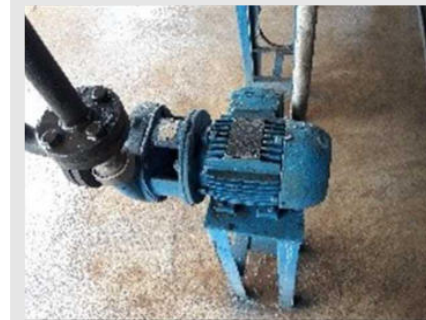
BRAA 01? BOMBA RESFRIADOR RAA MARCA CAPACIDADE: RPM 3425 / CV 1.0 | Item: 27 |
