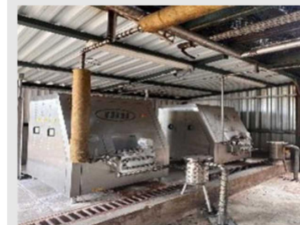
BAPH01/BAPH02 - BOMBAS HIDROLISE DE ALTA PRESSÃO MODELO - 25226 CAPACIDADE - 6000 L/H | Item: 83 |
