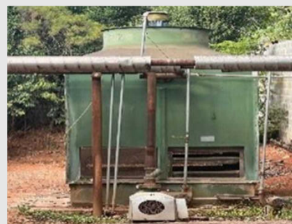
TR01 - TORRE RESFRIAMENTO CHILLERS | Item: 47 |
